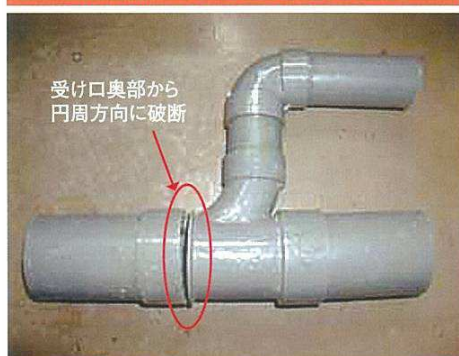
熱伸縮による破断事故例①
