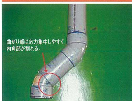
熱伸縮による破断事故例②
